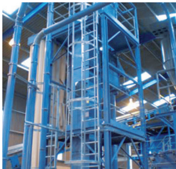
Fig. 2 : Séparateur gravimétrique avec plateforme de maintenance
